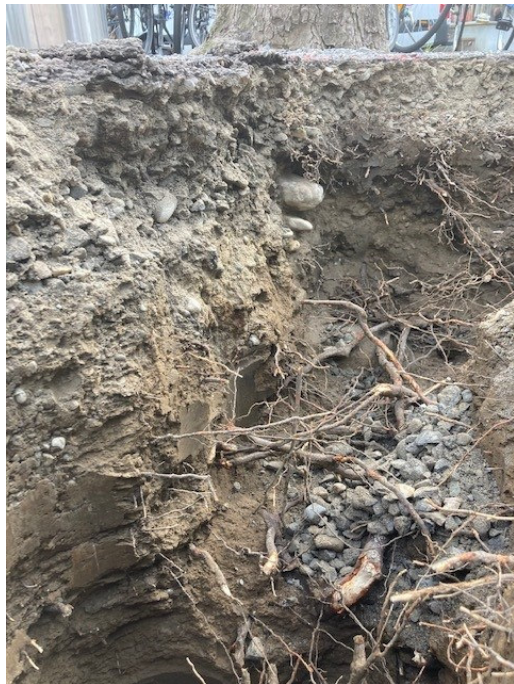
Starke Durchwurzelung ab einer Tiefe von 10 bis 30 cm
