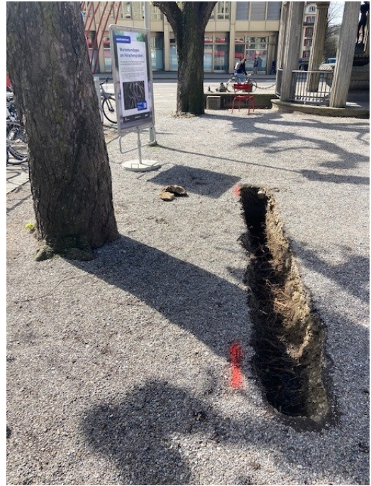
Graben mit einer Länge von 400 cm, um die Bodenverhältnisse auf der Südseite festzustellen
