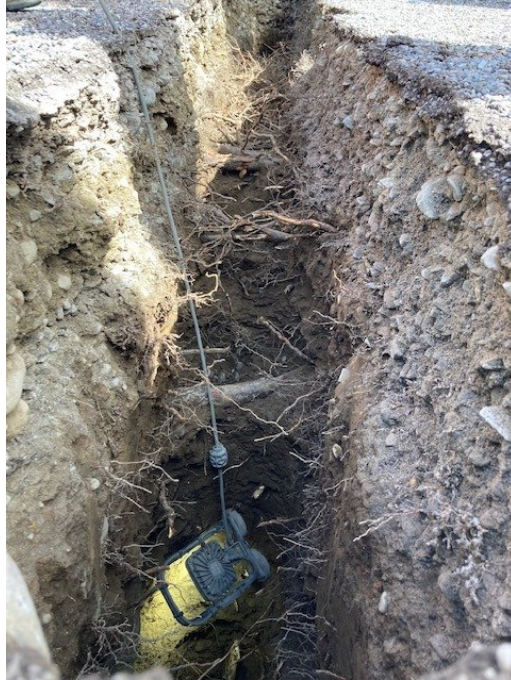
Starke Durchwurzelung ab einer Tiefe von 30 cm bis in eine Tiefe von mindestens 160 cm
