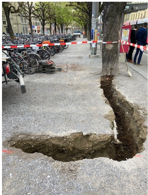
Bodenauftrag am Stammfuss 7 cm und in einer Entfernung von 4.5 m ab Stammmitte 40 cm
