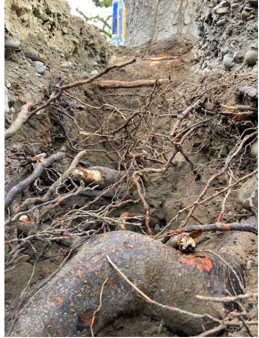
Starke Durchwurzelung unmittelbar unter dem eingebauten Wandkies
